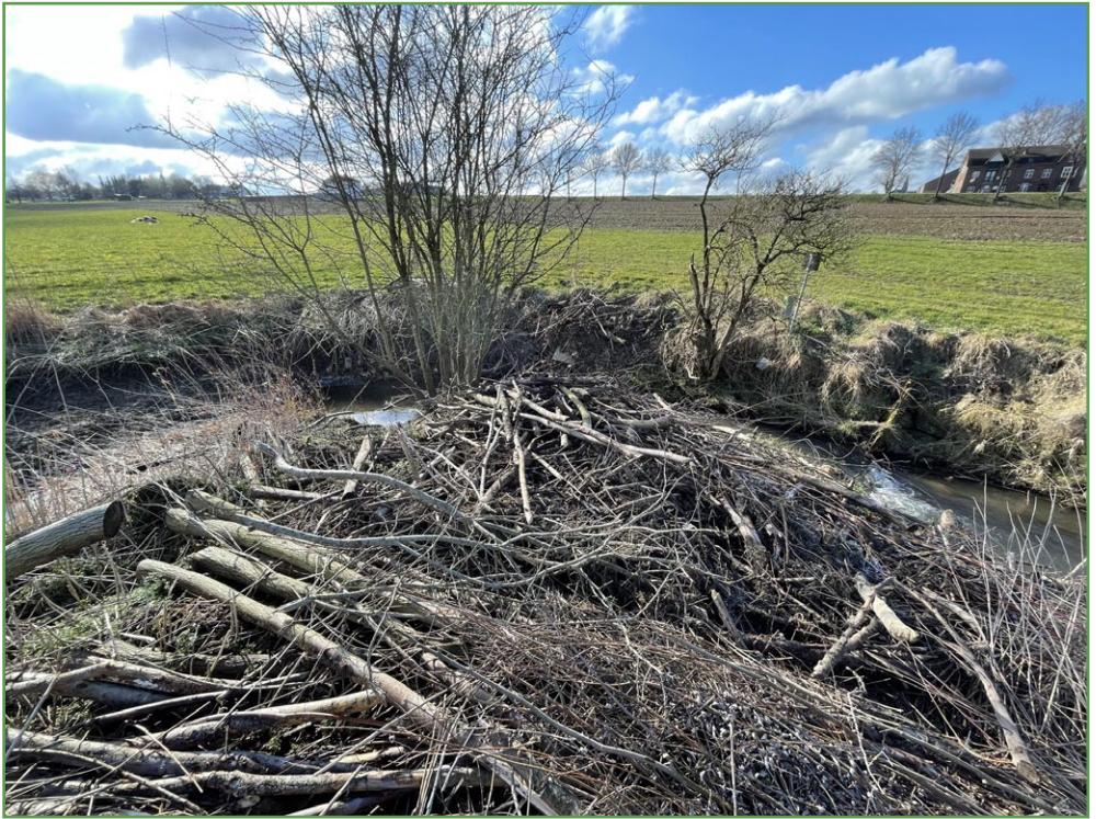
Foto 1-1: Bild von der Zerstörung am Senserbach
