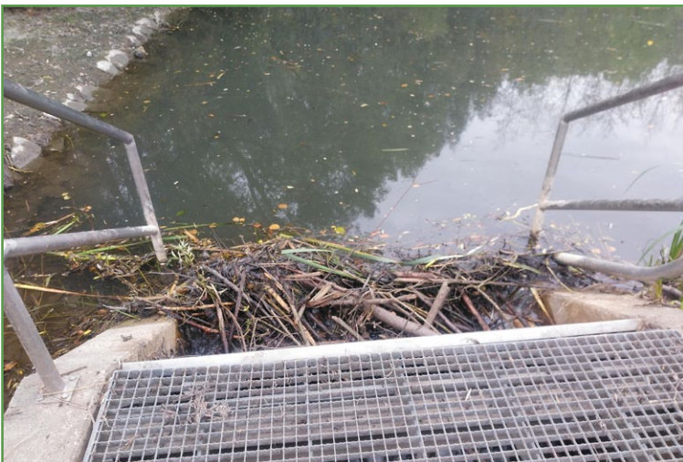
Foto 2-2 vom Biber halb zugebauter Wasserauslauf.
