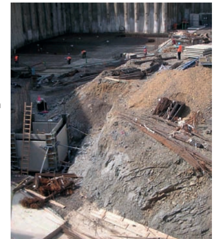
Abb. 1: Blick in die Baugrube am Kaiserplatz in westlicher Richtung. Im unteren Drittel ist das Fundament des Adalbertfelsens angeschnitten, die grauen, dünn geschichteten Ton- und Sandsteine des Condroz-Sandsteins.
