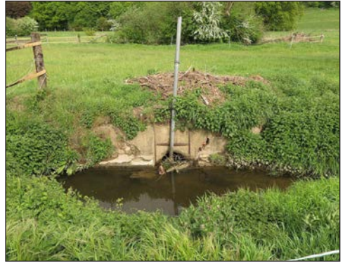
Abb. 4: Der Durchlass am Ende des Mühlengrabens ist so eng, dass er sich ständig mit Treibgut zusetzt.
